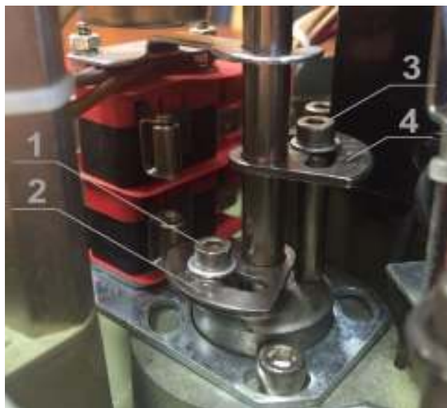
Рис. 3. Блок конечных выключателей
